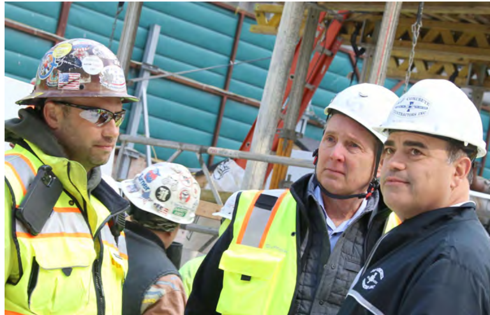
Anthony Frias III e Rodney Frias, ambos da S&F Concrete, durante os trabalhos na Winthrop Tower em Boston.
